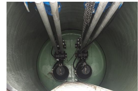
Figura 6 – Estação elevatória. Figure 6 – Lift station.
