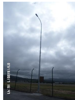
Figura 4 – Novos postes de iluminação Figure 4 – New Light poles.
