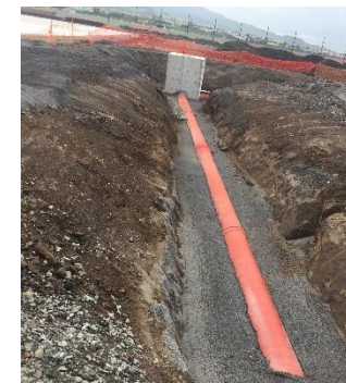
Figura 5 – Sistema de drenagem novo. Figure 5 – New drainage system.
