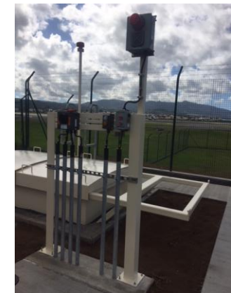
Figura 5 – Rack de equipamentos elétricos. Figure 5 – Electrical equipment rack.
