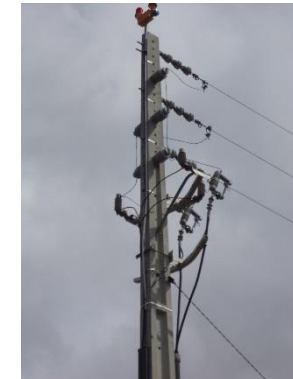
Figura 2 – Postes elétricos instalados.
